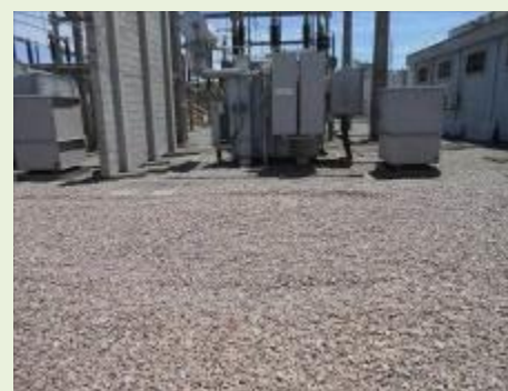
SUBESTAÇÃO PRINCIPAL ERG01
