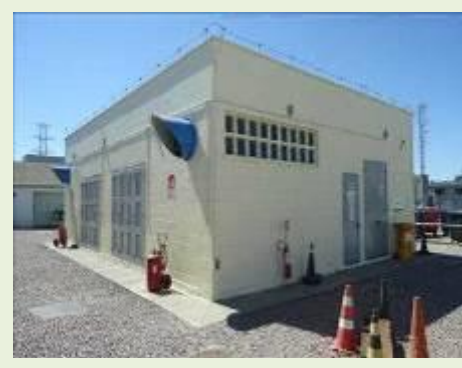
Vista da Subestação Epecista
