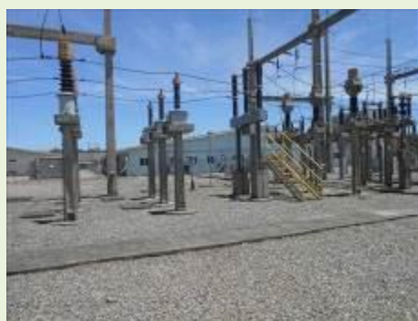
SUBESTAÇÃO PRINCIPAL ERG01
