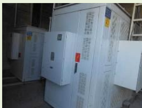
TRANSFORMADOR GAB 1 E 2 | Item: 100122 |
