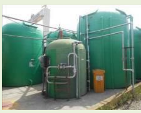
ETE NORTE CAP.165M3/H WHARTON | Item: 100158 |
