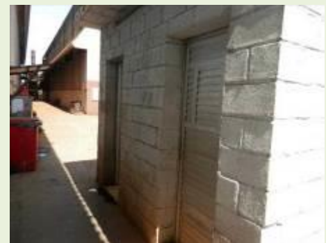
Vista do Sanitário do Oxycorte
