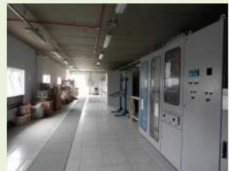
Vista Interna da Subestação Principal
