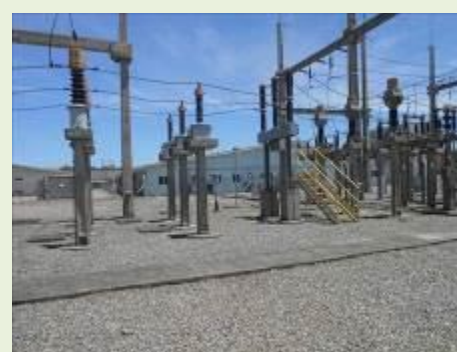
SUBESTAÇÃO PRINCIPAL ERG01 | Item: 100392 |
