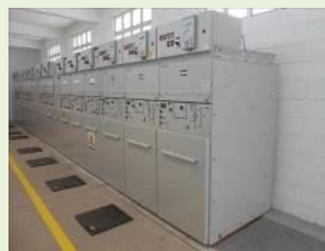
SUBESTAÇÃO PRINCIPAL ERG01 | Item: 100392 |
