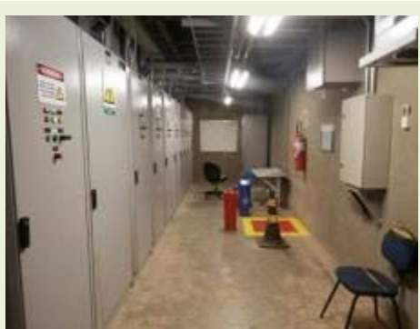
Vista Interna da Casa de Bombas do Dique
