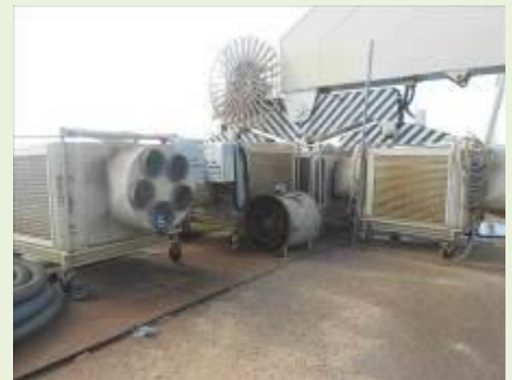
CLIMATIZADORES/ EVAPORIZADORES MARCA ROTOPLAST
