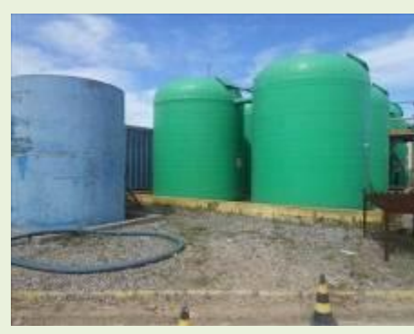
ETE NORTE CAP.165M3/H WHARTON | Item: 100158 |
