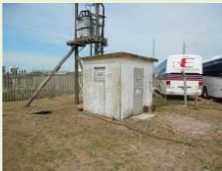
Vista da Cabine de Entrada de Força
