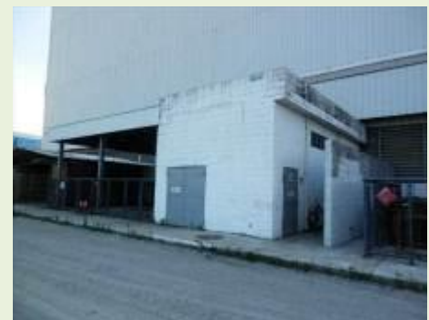
Vista da Subestação e Cobertura do Gerador
