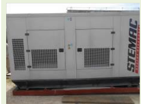
GRUPO GERADOR MARCA STEMAC SERIE ST-0500064112 POT.500/445KVA COM GERADOR WEG GTA E MOTOR DIESEL SCANIA DC-13072 (20GG001) | Item: 294595 |
