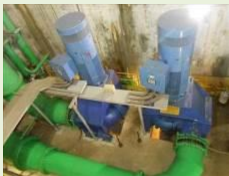
BOMBA MARCA KSB MOD.KVP 300-500K OP.080643 Q=1.000M3/H H=22 COM MOTOR WEG 125CV E BASE ACO | Item: 500365 |
