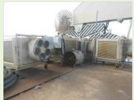
CLIMATIZADORES/ EVAPORIZADORES MARCA ROTOPLAST COM MOTOR 10CV | Item: 100256 |
