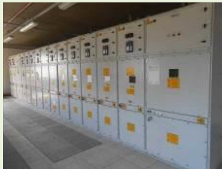
SUBESTAÇÃO PRINCIPAL ERG 02 | Item: 100227 |
