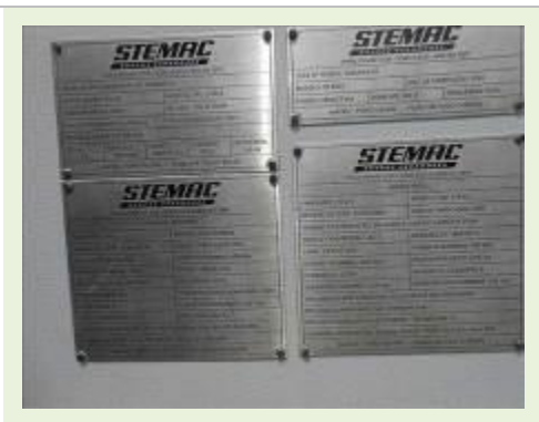
GRUPO GERADOR MARCA STEMAC | Item: 294595 |
