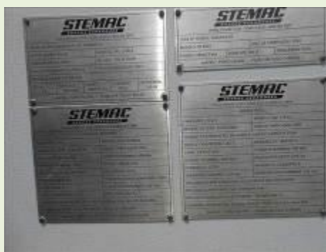
GRUPO GERADOR MARCA STEMAC SERIE ST-0500064112 POT.500/445KVA COM GERADOR WEG GTA E MOTOR DIESEL SCANIA DC-13072 (20GG001) | Item: 294595 |
