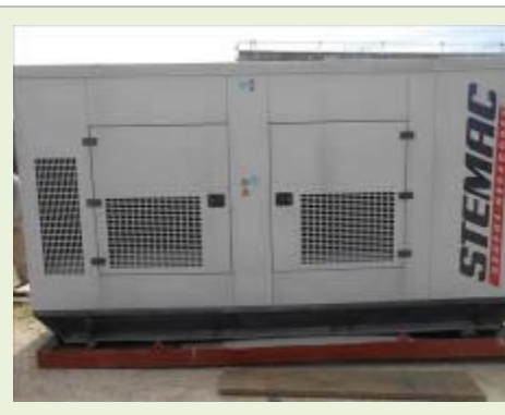
GRUPO GERADOR MARCA STEMAC | Item: 294595 |
