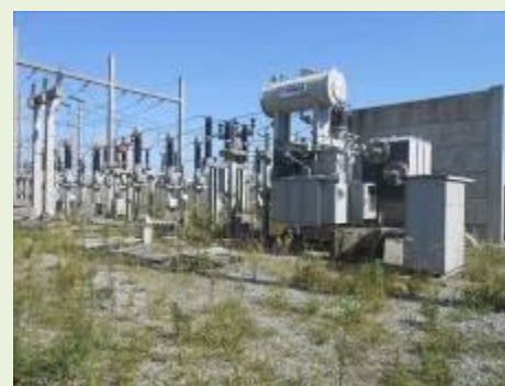
SUBESTAÇÃO PRINCIPAL ERG 02 | Item: 100227 |
