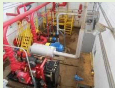
BOMBA P COMBATE A INCENDIO MARCA GERMEK / ASVAC MOD. TMDL 32/3 COM 3 ESTAGIOS ACIONADA POR MOTOR VOLVO DIESEL | Item: 500191 |
