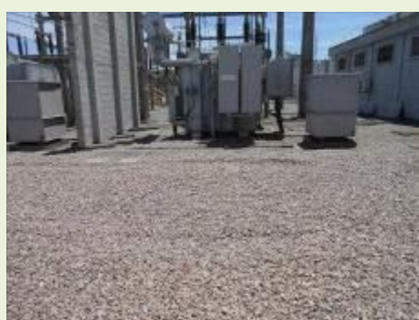
SUBESTAÇÃO PRINCIPAL ERG01 | Item: 100392 |
