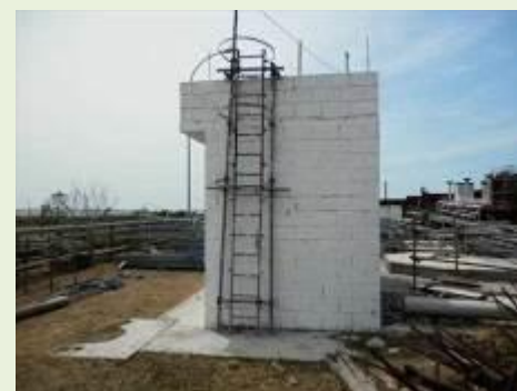
Vista da ETE 1 e 2
