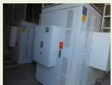
TRANSFORMADOR GAB 1 E 2 | Item: 100122 |
