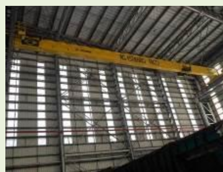
PONTE ROLANTE MONOVIGA MARCA TERTECMAN CAP. 5T. VÃO 30X16M ALTURA COMANDO CONTROLE REMOTO (70PR004) | Item: 510240 |
