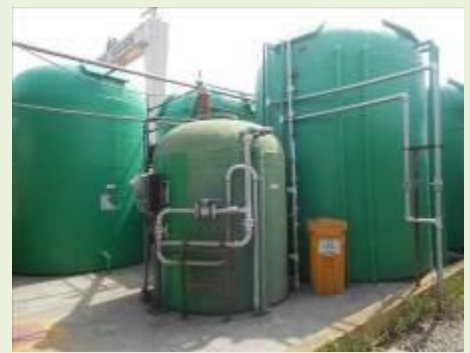
ETE NORTE CAP.165M3/H WHARTON | Item: 100158 |
