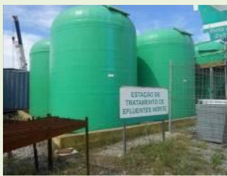
ETE NORTE CAP.165M3/H WHARTON | Item: 100158 |
