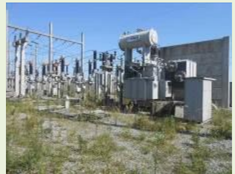
SUBESTAÇÃO PRINCIPAL ERG 02 | Item: 100227 |
