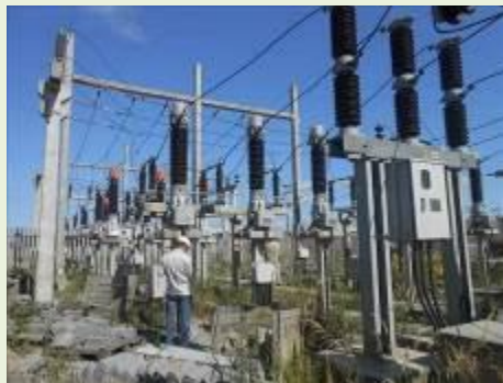
SUBESTAÇÃO PRINCIPAL ERG 02
