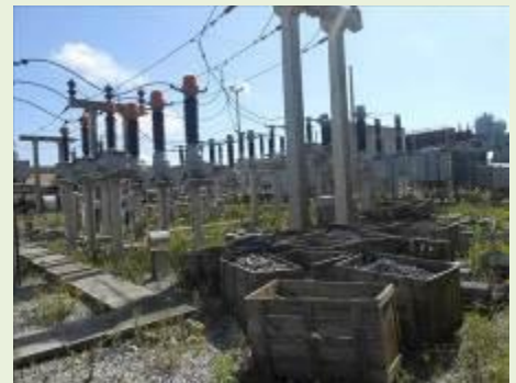
SUBESTAÇÃO PRINCIPAL ERG 02
