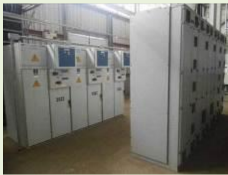
PAINÉIS E CUBÍCULOS GAB 01 E 2 | Item: 100122 |
