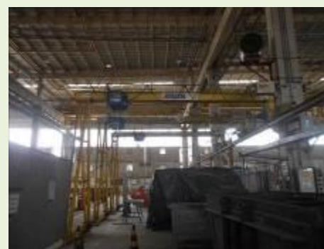
SEMI PÓRTICO MARCA ABUS TIPO EPK 2000KG NR.FABR. 118873 VÃO7X 5M ALTURA (SPT-004) | Item: 305735 |
