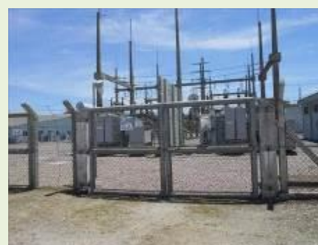
SUBESTAÇÃO PRINCIPAL ERG01 | Item: 100392 |
