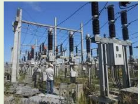
SUBESTAÇÃO PRINCIPAL ERG 02 | Item: 100227 |
