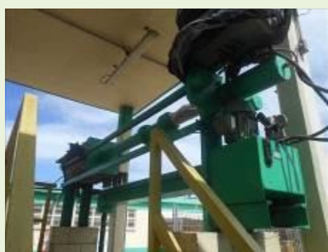
ETE NORTE CAP.165M3/H WHARTON | Item: 100158 |
