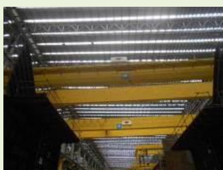
PONTE ROLANTE BIVIGA MARCA TRUCKFORT OF.10/1078F CAPAC 30T VÃO 44X13,3M ALTURA, COM COMANDO CONTROLE REMOTO (24PR002) | Item: 295621 |
