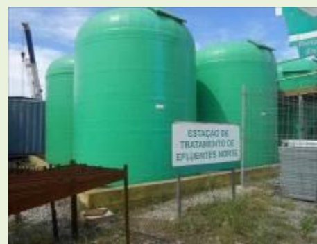
ETE NORTE CAP.165M3/H WHARTON | Item: 100158 |
