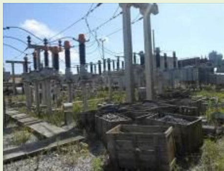
SUBESTAÇÃO PRINCIPAL ERG 02 | Item: 100227 |
