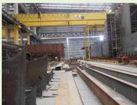
PONTE ROLANTE BIVIGA MARCA TRUCKFORT OF.10/1078B VÃO 44X13,3M ALTURA CAP.30T. | Item: 305653 |
