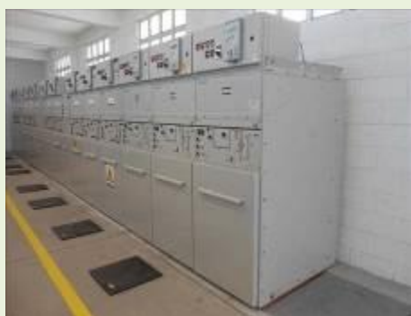
SUBESTAÇÃO PRINCIPAL ERG01
