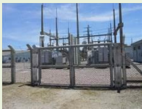
SUBESTAÇÃO PRINCIPAL ERG01
