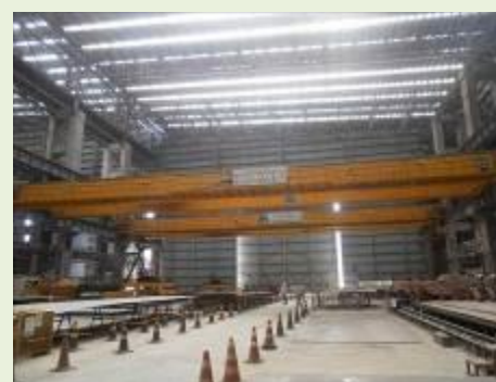
PONTE ROLANTE BIVIGA MARCA ANUPAM NR.KIF-2062 CAP. 15T. VÃO 44X8M ALTURA COM ELETROIMÃ (22PR004) | Item: 510224 |
