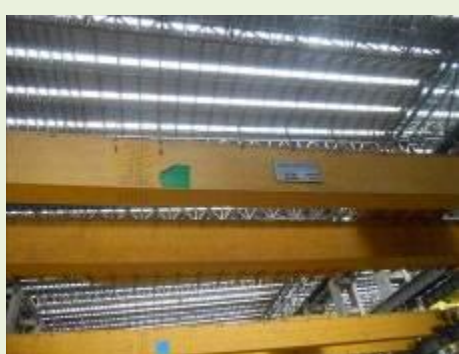
PONTE ROLANTE BIVIGA MARCA ANUPAM NR.KIF-2062 CAP. 15T. VÃO 44X8M ALTURA COM ELETROIMÃ (22PR003) | Item: 510225 |
