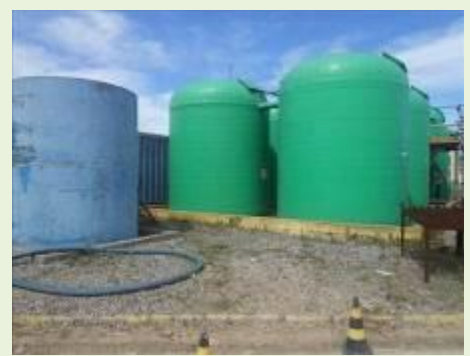
ETE NORTE CAP.165M3/H WHARTON | Item: 100158 |
