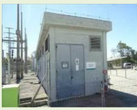
Vista da Subestação Principal
