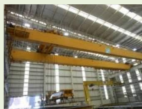
PONTE ROLANTE BIVIGA MARCA ANUPAM NR.2066 VÃO 28X8M ALTURA CAP.15T. COMANDO CONTROLE REMOTO, COM ELETROIMA DE 15T. (21PR001) | Item: 295642 |
