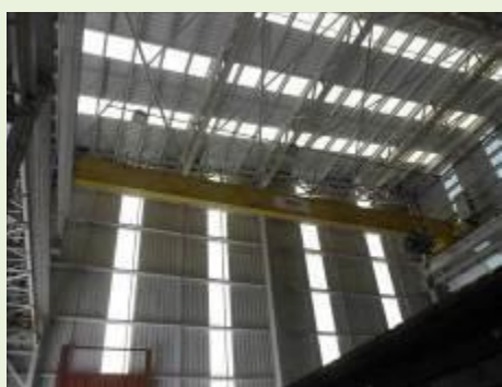
PONTE ROLANTE MONOVIGA MARCA TRUCKFORT OF.10/1078K CAP. 5T. VÃO 18X9M ALTURA (21PR003) | Item: 510230 |
