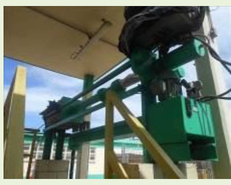
ETE NORTE CAP.165M3/H WHARTON | Item: 100158 |
