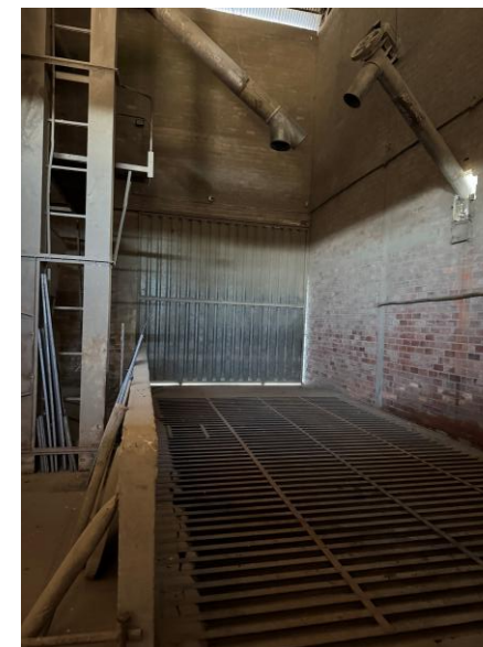
Fotos enviadas pela Recuperanda em 26/09/2025
