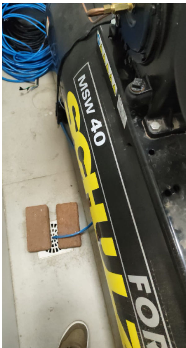
32- 1 compressor MSW 40, bom estado.
