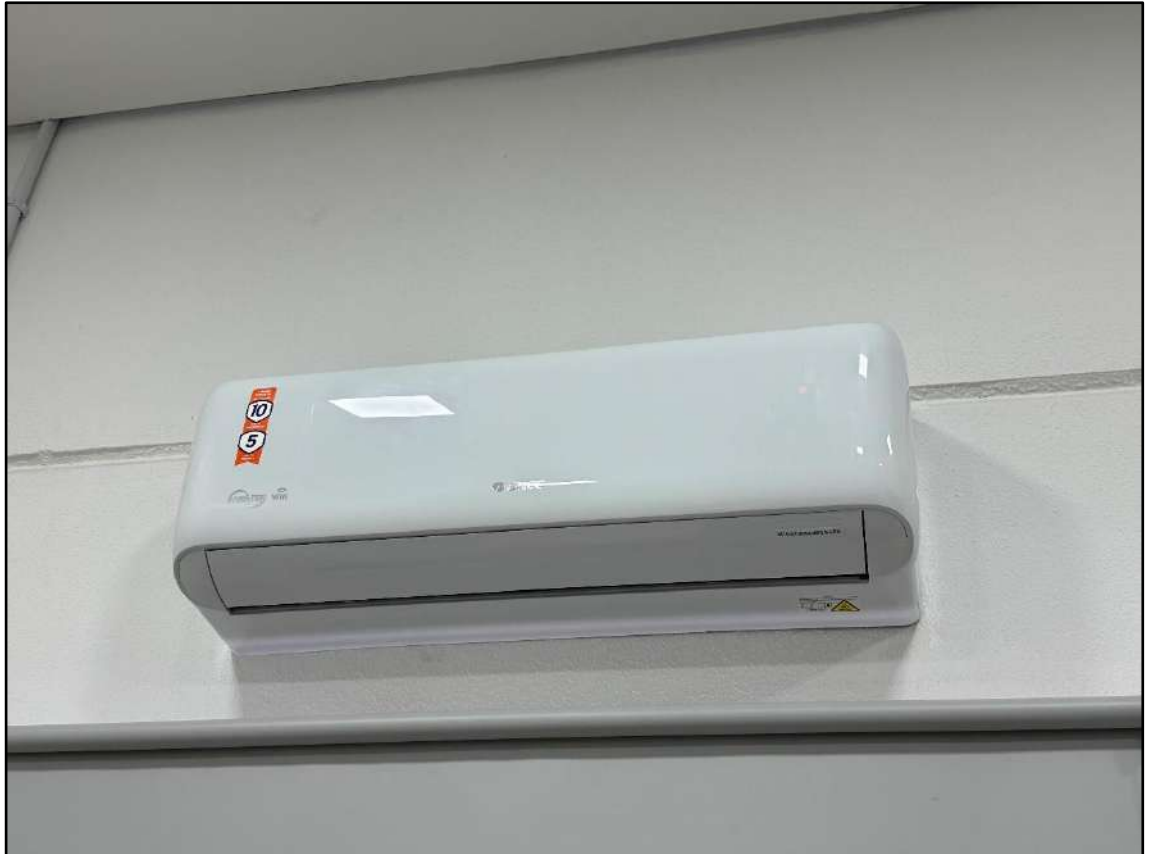
ITEM 011 - AR CONDICIONADO GREE
