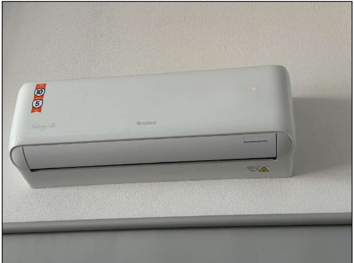
ITEM 011 - AR CONDICIONADO GREE
