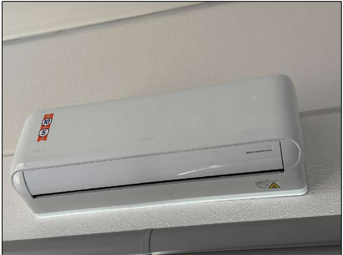
ITEM 011 - AR CONDICIONADO GREE
