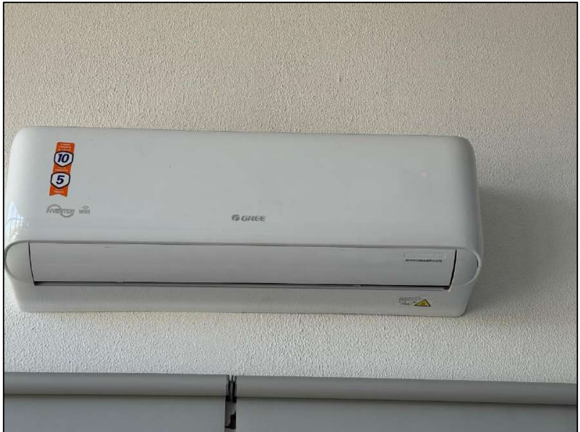
ITEM 011 - AR CONDICIONADO GREE
