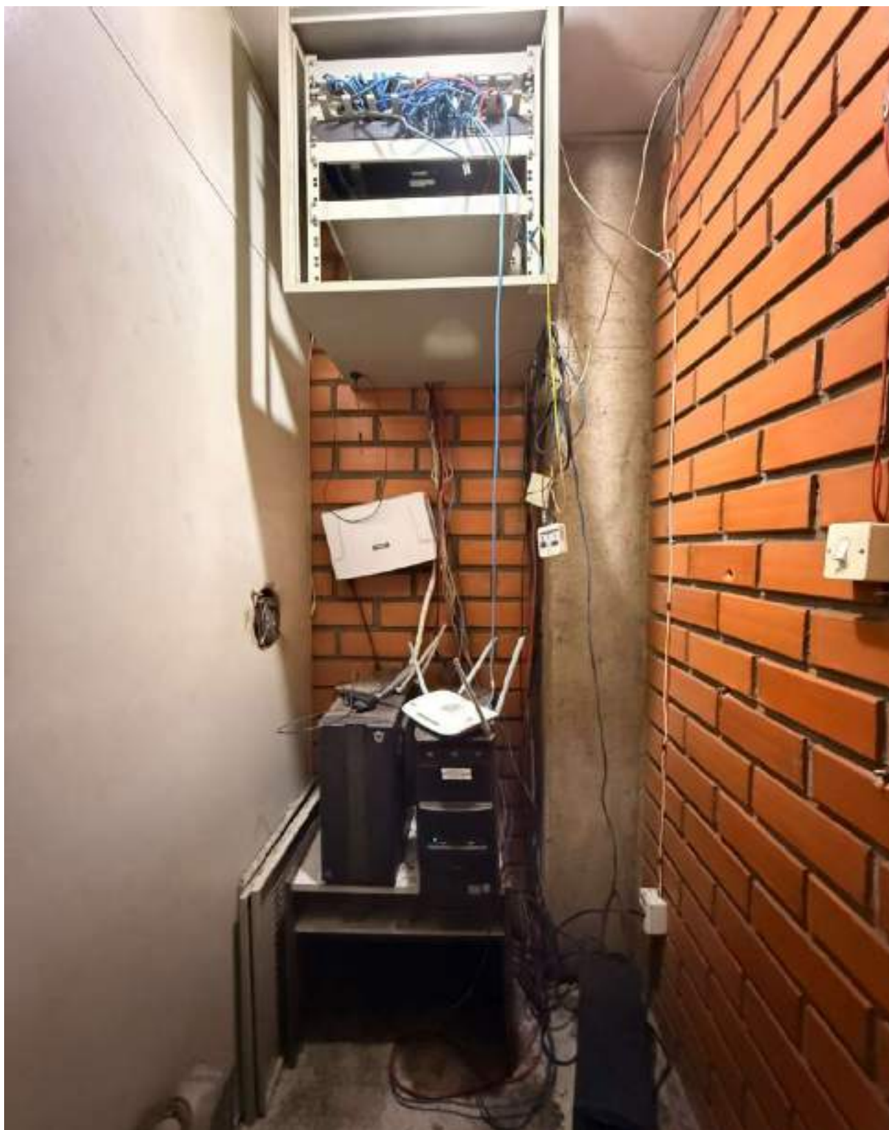
Figura 15 - Móveis e equipamentos de informática – Servidor/Central telefônica.
