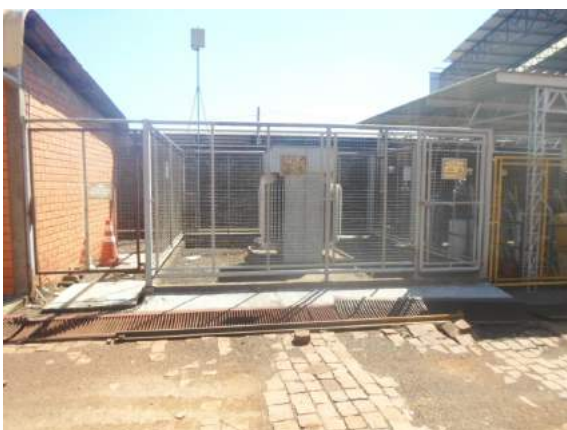
Foto 59: Benf 29, Abrigo Transformador
