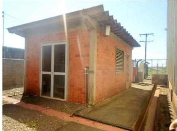
Foto 56: Benfeitoria 02, Abrigo Gerador
