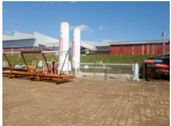
Foto 64: Benfeitoria 25, Reservatório GLP
