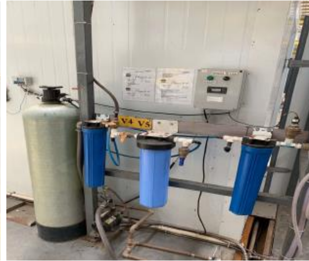
Tratamento de água
