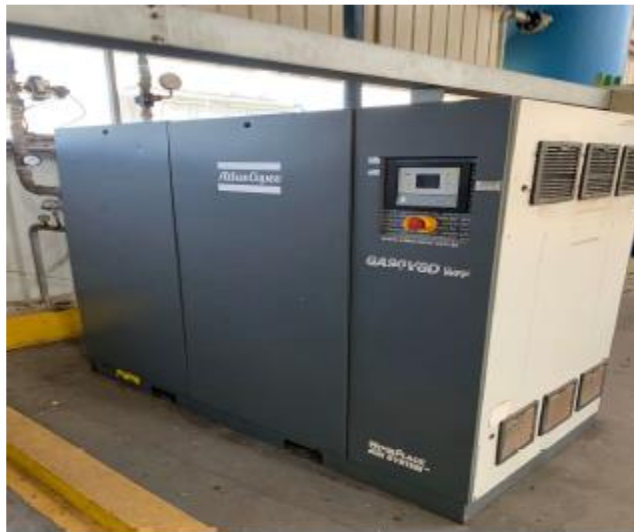
Compressor de ar
