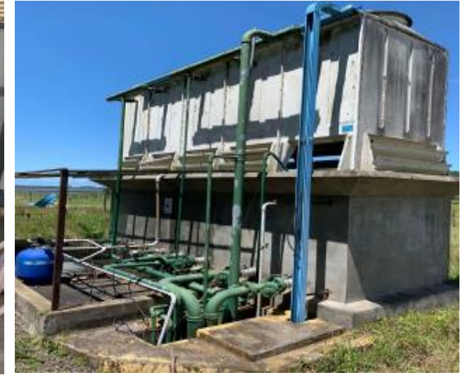
Torre de resfriamento
