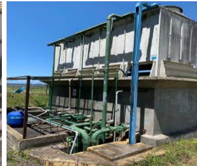
Torre de resfriamento
