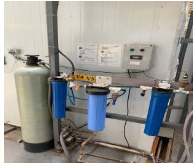
Tratamento de água
