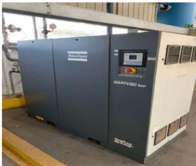
Compressor de ar
