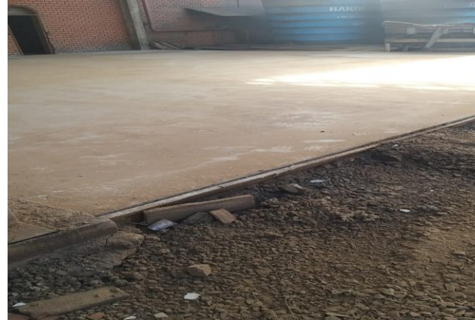
Piso base do ciclone.
