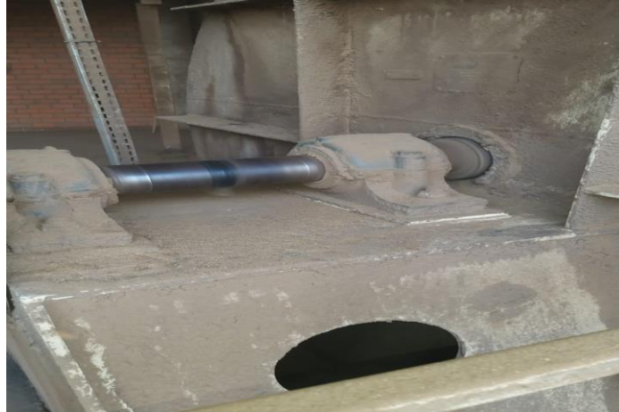
Ventilador central do pó.
