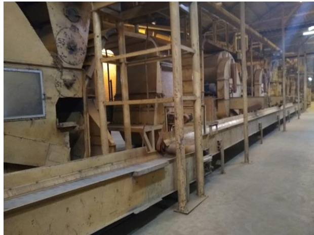
Máquina que realiza o processamento de fumo.
