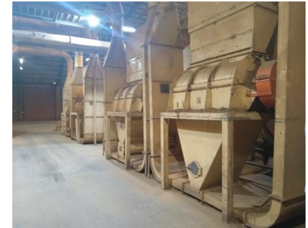
Máquina que realiza o processamento de fumo.
