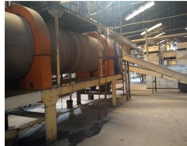
Máquina que realiza o processamento de fumo.
