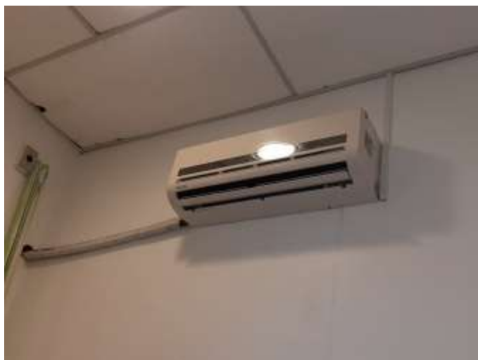
Item 180: Um ar condicionado Elgin.
