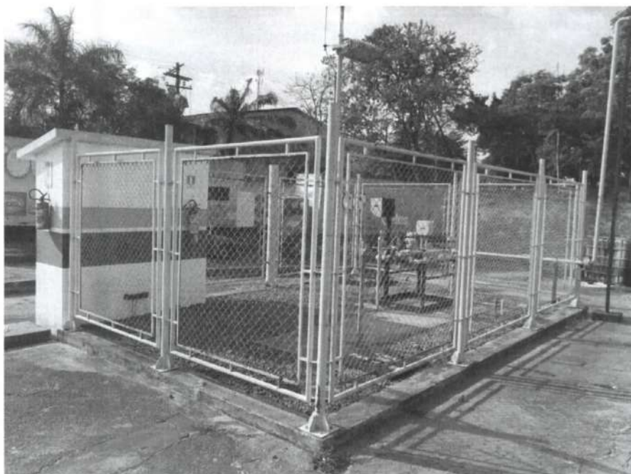
Foto nº 2 – Estação de Gás Natural – vista lateral
