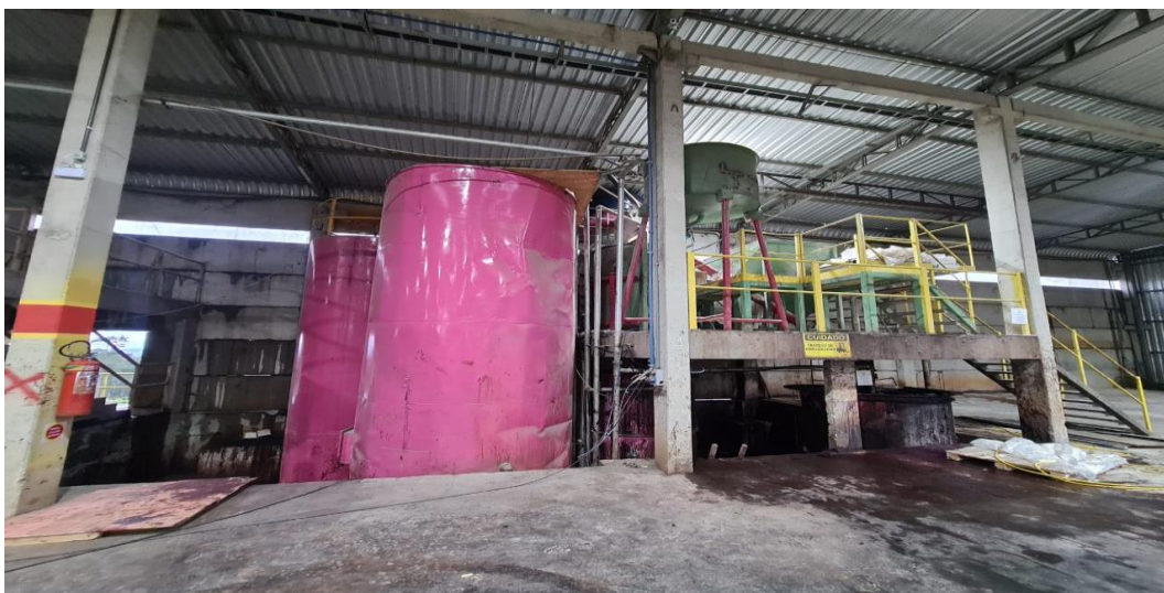
Reservatório de resina
