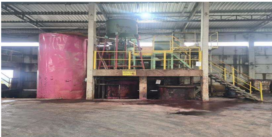
Reservatório de resina
