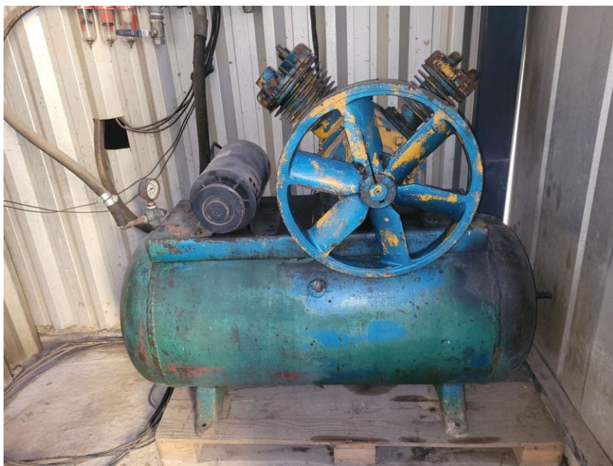
COMPRESSOR DE AR
